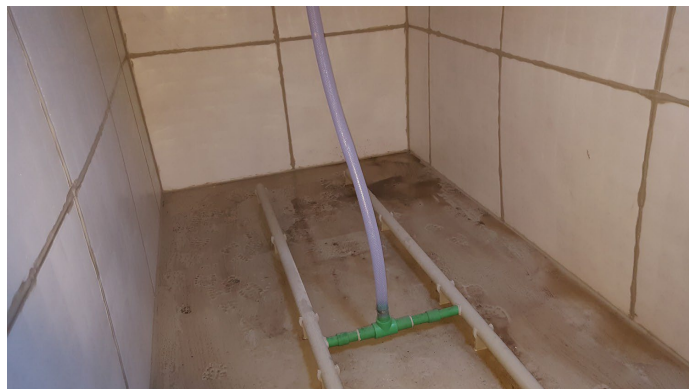
Slika 3.3. Izgled aerisanog bazena za egalizaciju
