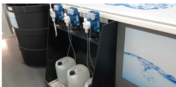
Slika 3.5. Izgled dozirne stanice
