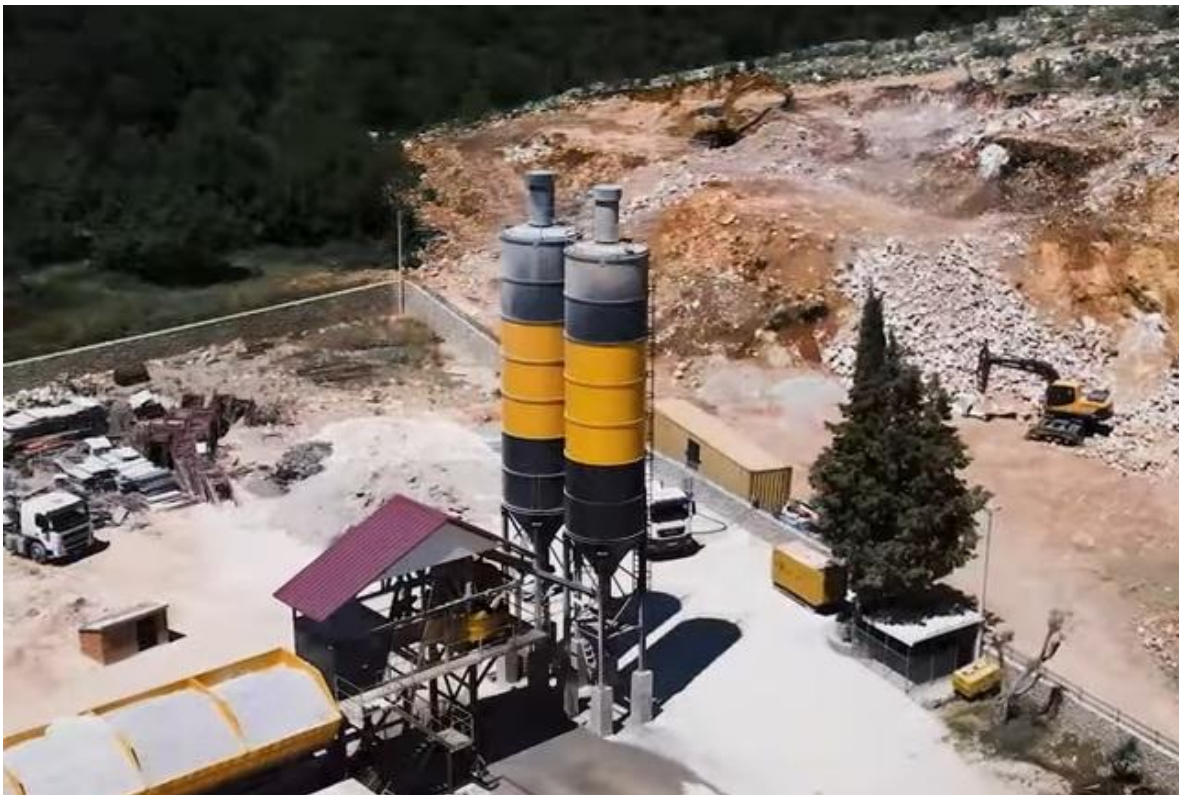
Stika 5. Silosi za skladištenje cementa
