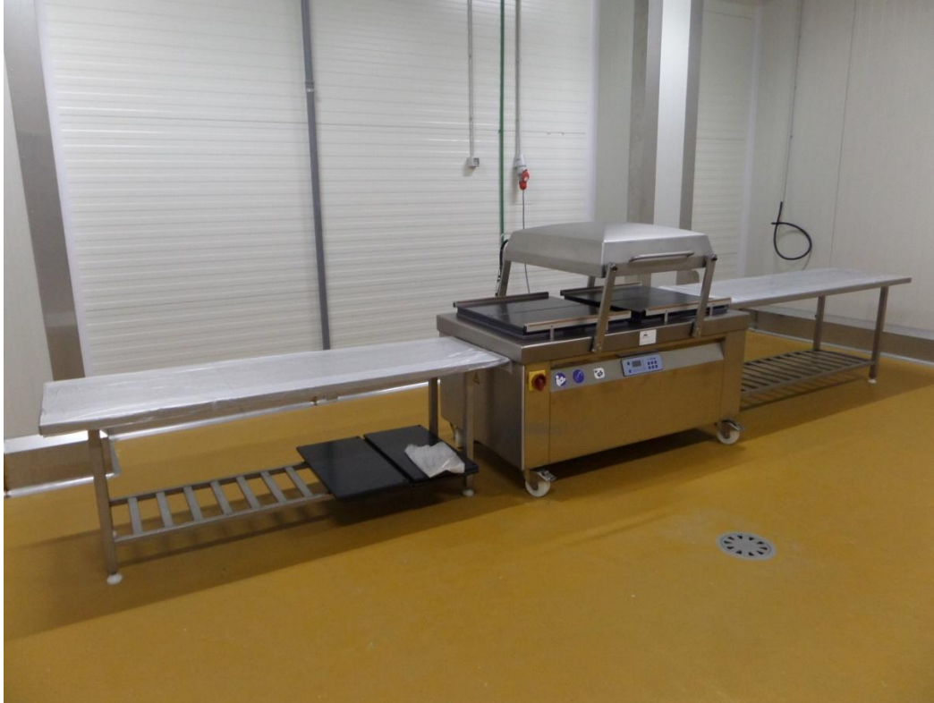
Slika 7. Prostor u okviru kojeg je predviđeno instaliranje mašine za pakovanje Multivac R085
